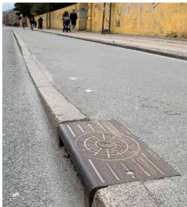
Dykket kantsten og sideindløbsbrønd på Nørrebrogade
