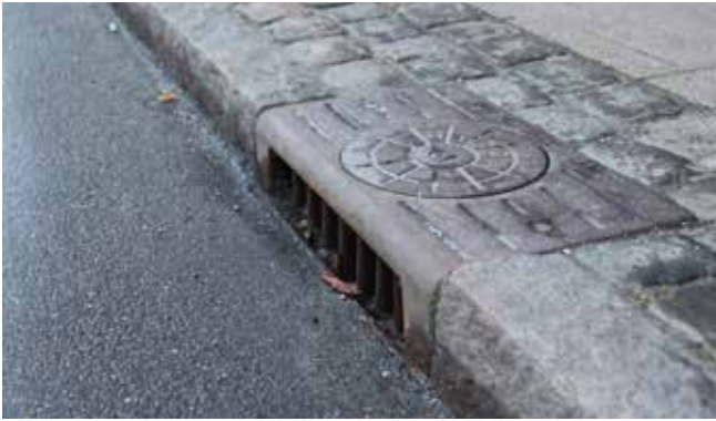
Sideindløbsbrønd på Stormgade
