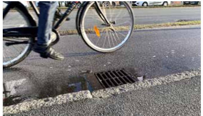
Afløbsrist med lamellerne vinkelret til køreretning på cykelstien på Ørestads Boulevard
